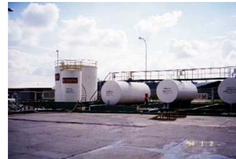
FOTO. 6.11. INSTALACIONES PARA ALMACENAMIENTO DE COMBUSTIBLES
