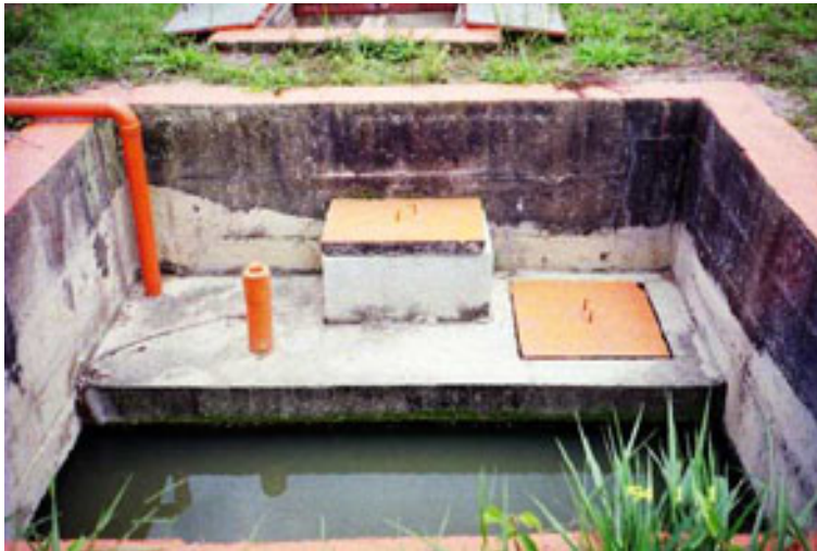
FOTO 8-2.1 PLANTA DE LODOS ACTIVADOS
