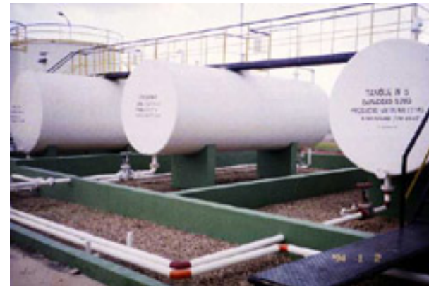
FOTO 6.4. BASES PARA TANQUES HORIZONTALES
