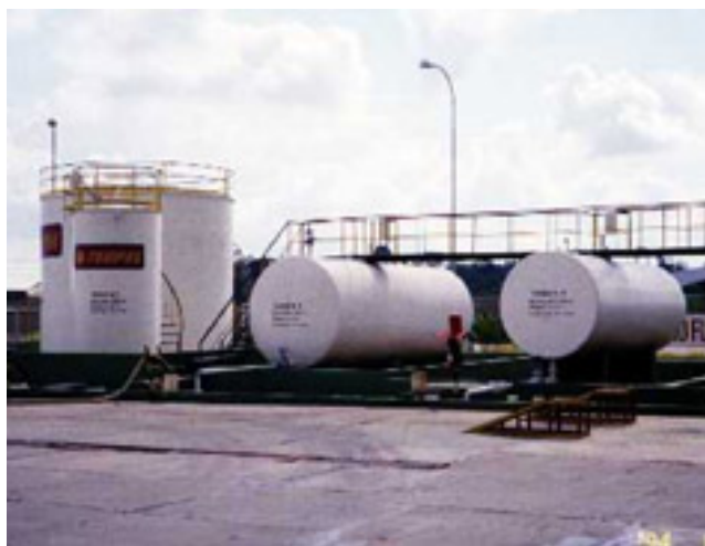
FOTO 6.3. INSTALACIÓN DE ALMACENAMIENTO DE COMBUSTIBLE
